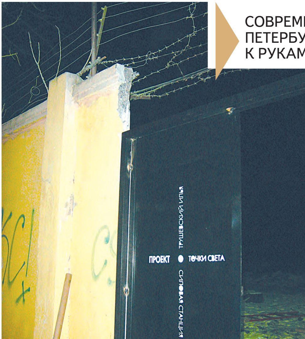
Кроме «точек света» на подстанции трудно что-либо разглядеть. Только чернота да искореженные бетонные поверхности.
