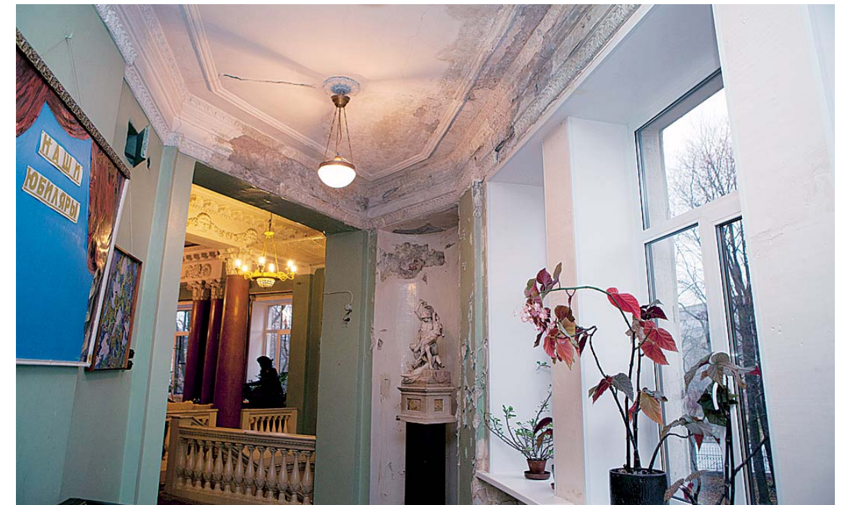
Дому ветеранов сцены ремонт нужен как воздух.
