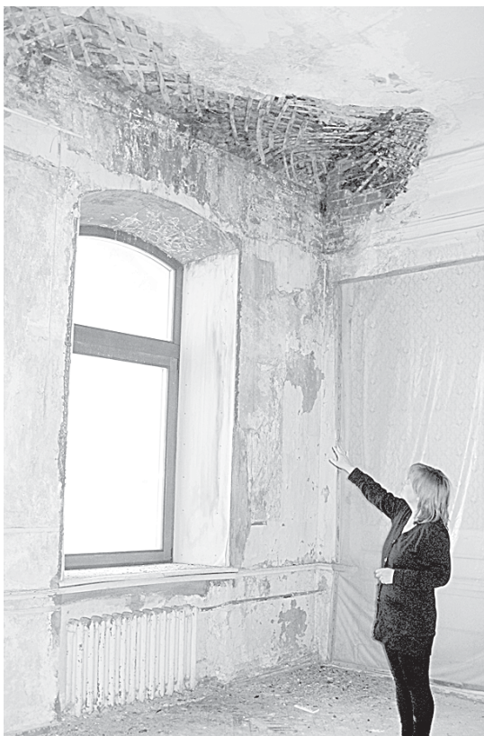
Из этого окна у Галины Белковой открывается парадный вид на Неву — под провисающим и прогнившим потолком.
