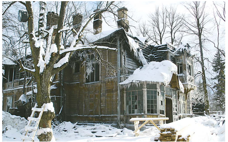
Февраль 2011 года: при пожаре памятника регионального значения пострадали крыша, два этажа, лестница, камин.
