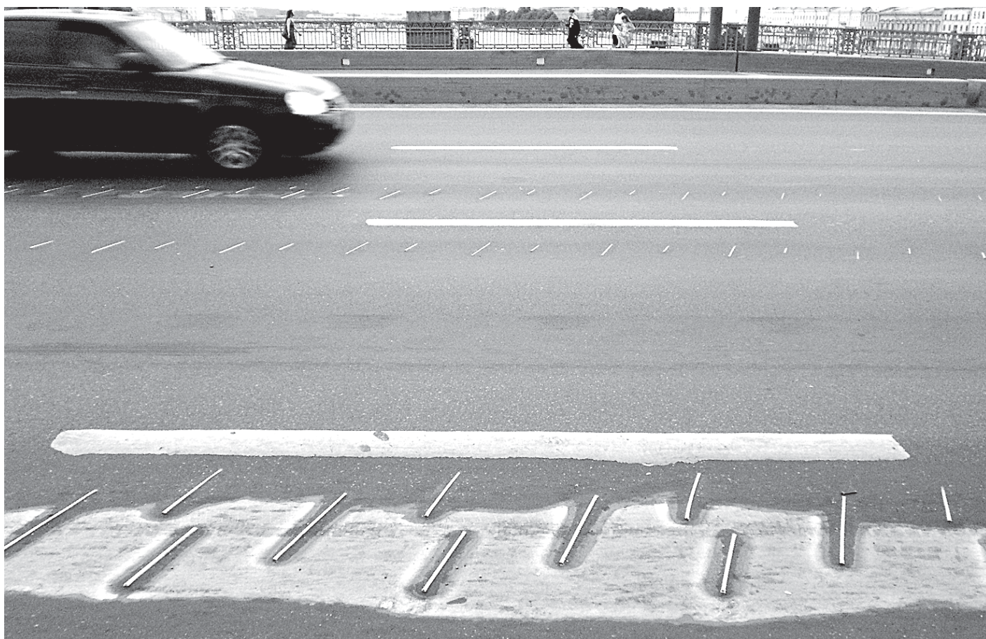
Асфальт на мосту стерся до такой степени, что сквозь истончившийся слой уже просвечивает металл.
