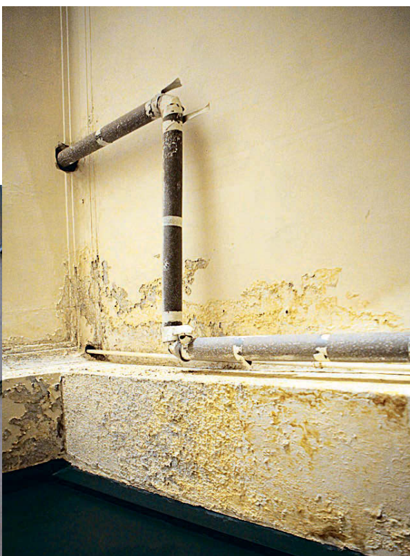
Грибок на стенах не волнует жильцов.
