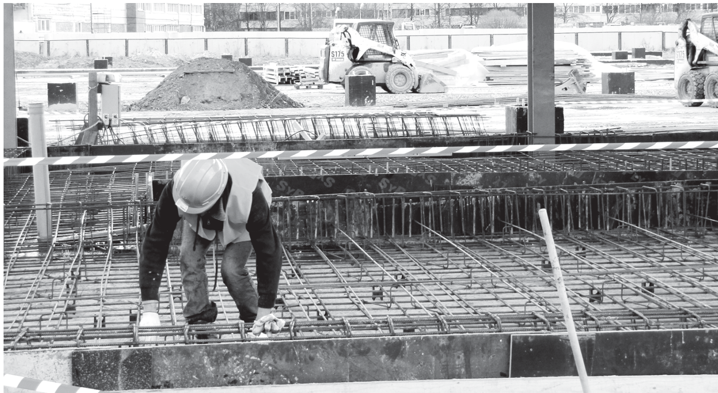
Работы нулевого цикла закончены, скоро приступят к установке холодильных плит на дорожках по кольцу арены.
