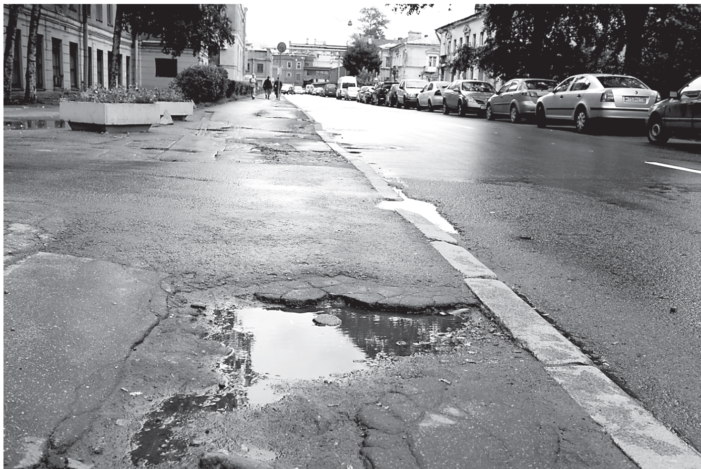
К сожалению, сейчас такие дефекты асфальта на наших дорогах — обычное явление.
