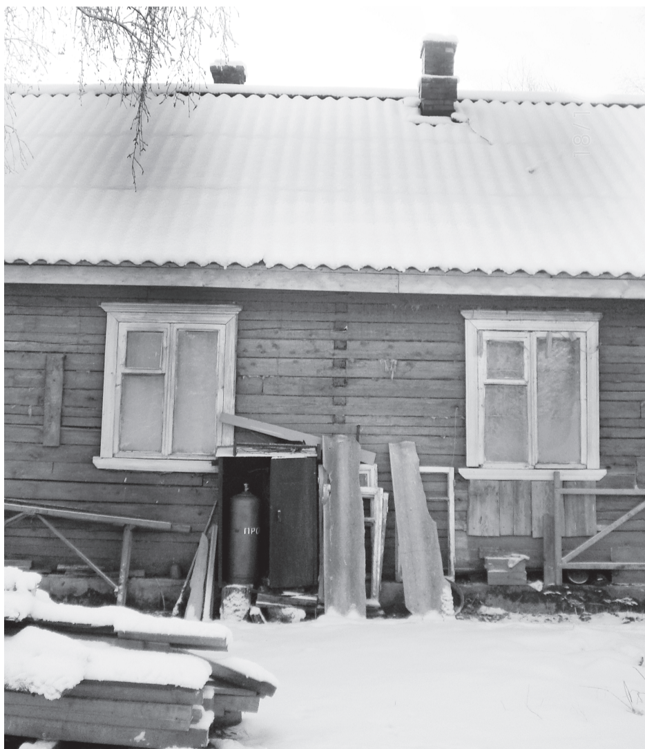
Жилище 88-летней Александры Ивановой. В доме прогнили стены, пришли в негодное состояние полы, печь, фундамент. Туалет разрушен. Отопления и канализации нет. До ближайшего водоема — 300 метров.
