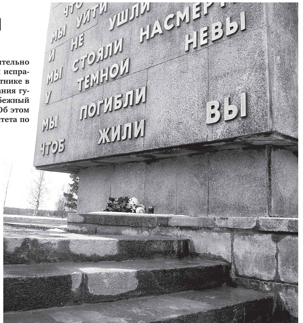
Щели между гранитными плитами грубо замазаны.
