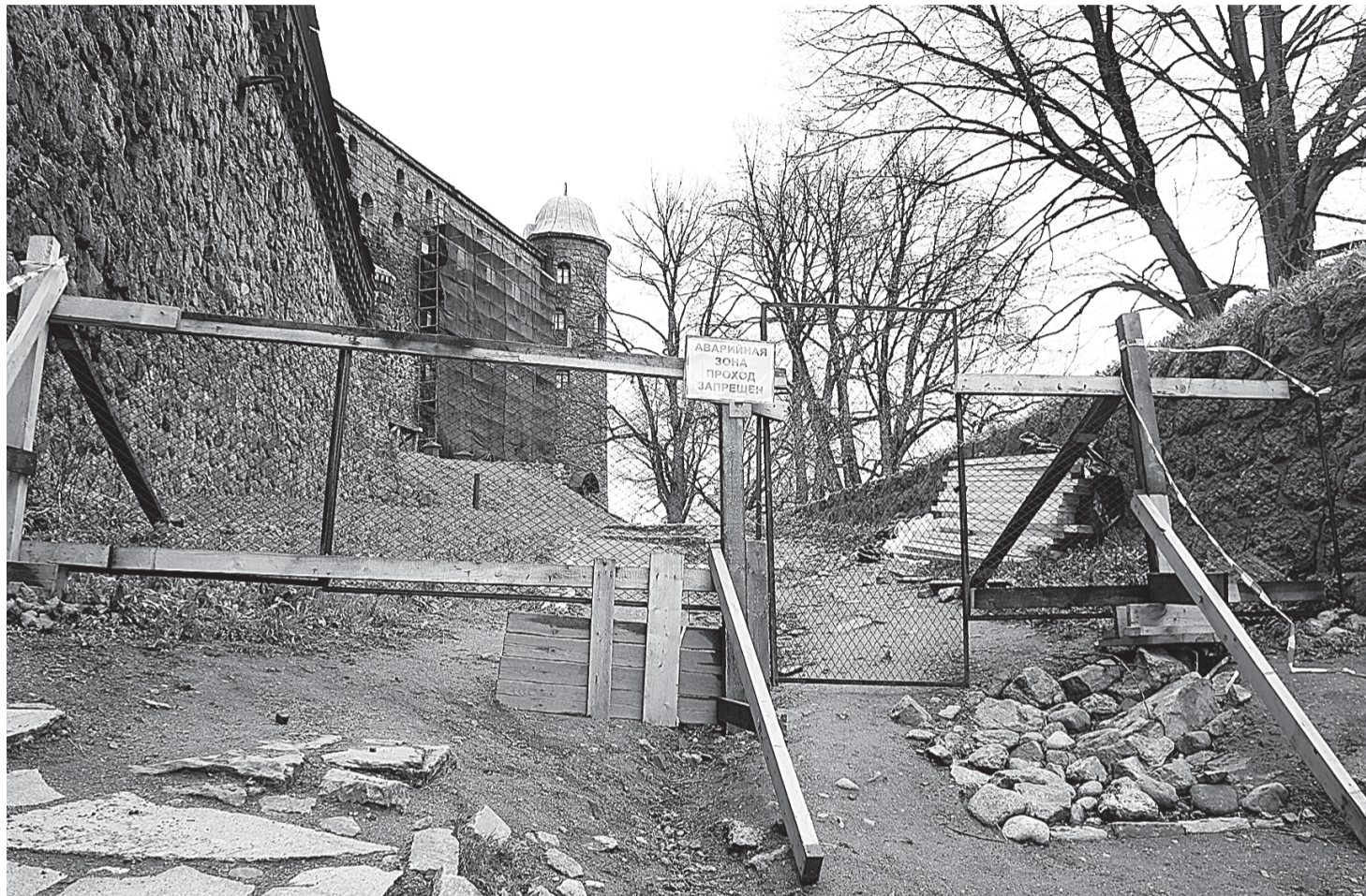
Места обрушений прикрыты строительной сеткой.
