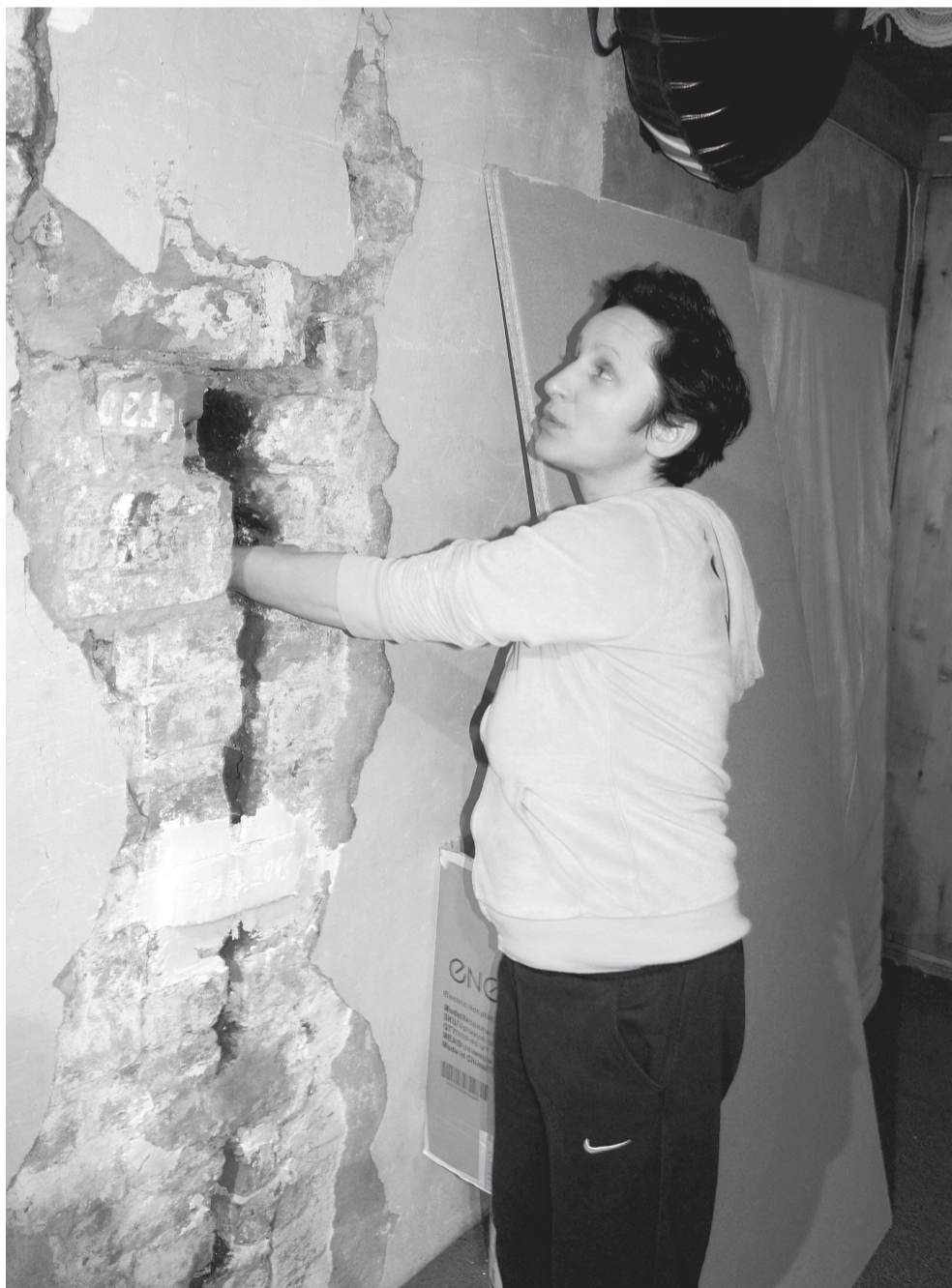
Жильцам дома остается только наблюдать, как увеличиваются трещины в стенах.
