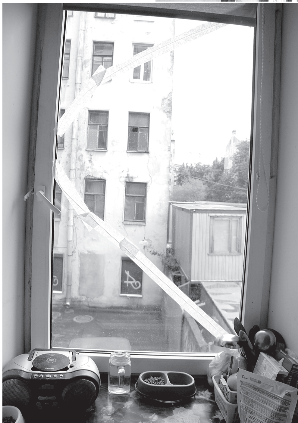
...а стеклопакеты в перекошенных оконных проемах идут трещинами.
