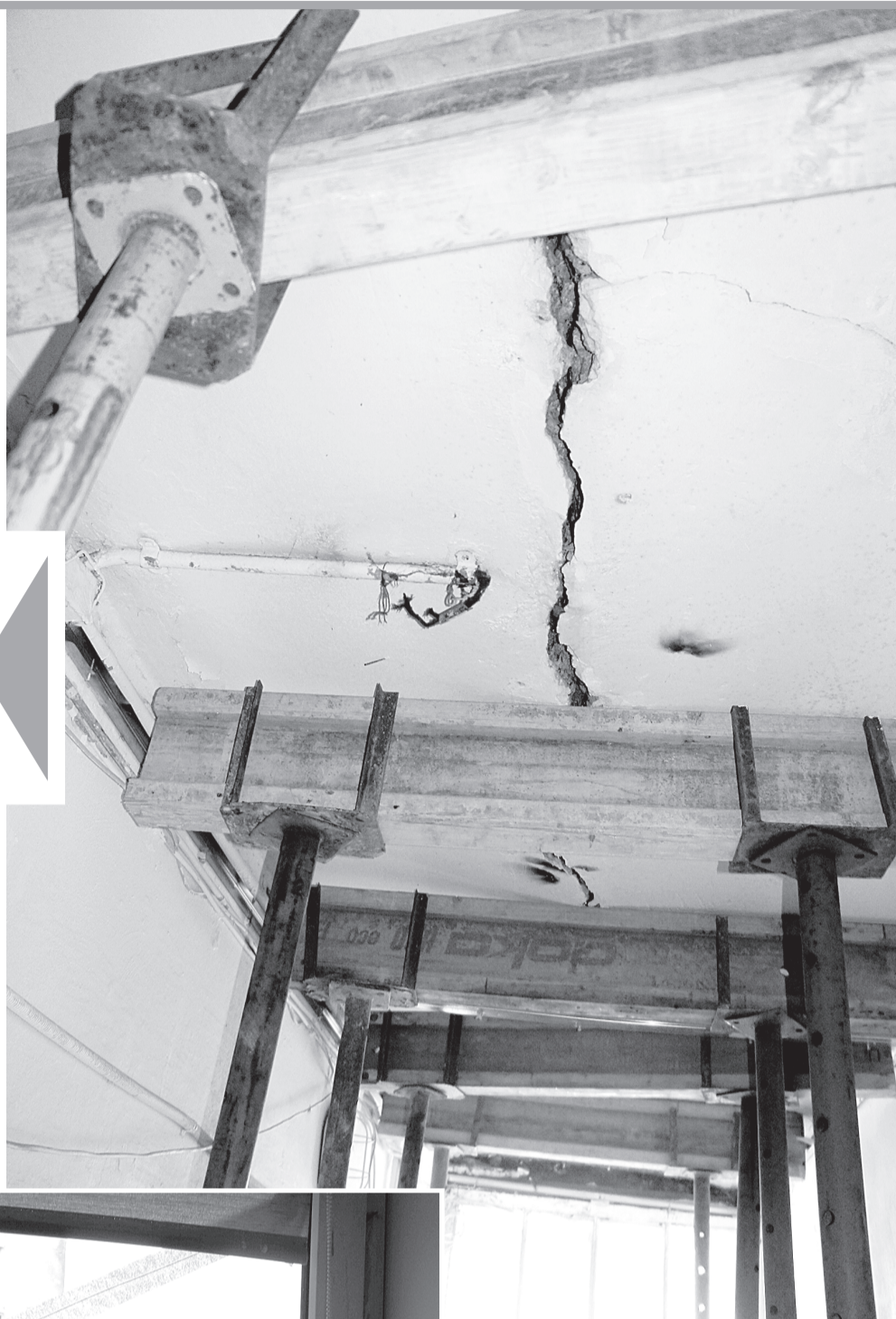
Потолки злополучного дома держатся на подпорках...
